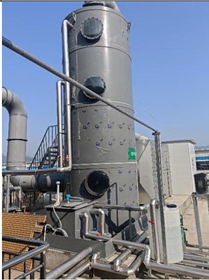
DA003 废水站废气排口
