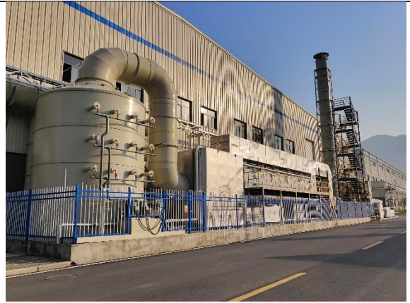
DA002 烤箱注液化成废气排放口
