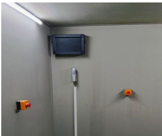
图 3-11 铅房内部紧急停机按钮
