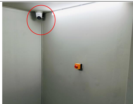
图 3-19 铅房内高清摄像装置
